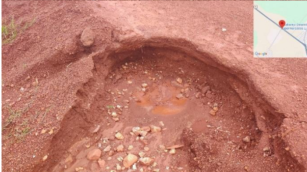
Processo erosivo identificado GO-210/174 Rio Verde 22K 506706 8036723 Altitude:775.1msnm Velocidade:0.0km/h 06/02/2026 13:11:47.774
