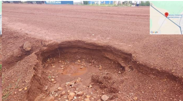
Processo erosivo identificado GO-210/174 Rio Verde 22K 506706 8036722 Altitude:773.9msnm Velocidade:0.0km/h 06/02/2026 13:11:43.512
