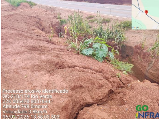
Processo erosivo identificado GO-210/174 Rio Verde 22K 505490 8037637 Altitude:795.9msnm Velocidade:0.0km/h 06/02/2026 13:57:43.038
