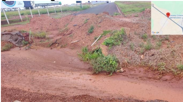
Processo erosivo identificado GO-210/174 Rio Verde 22K 506682 8036744 Altitude:777.2msnm Velocidade:0.0km/h 06/02/2026 13:13:21.052
