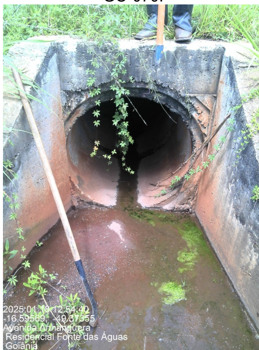
Figura 31. Bueiro BSTC de diâmetro 1,00 m localizado na estaca 386 da rodovia GO-070.
