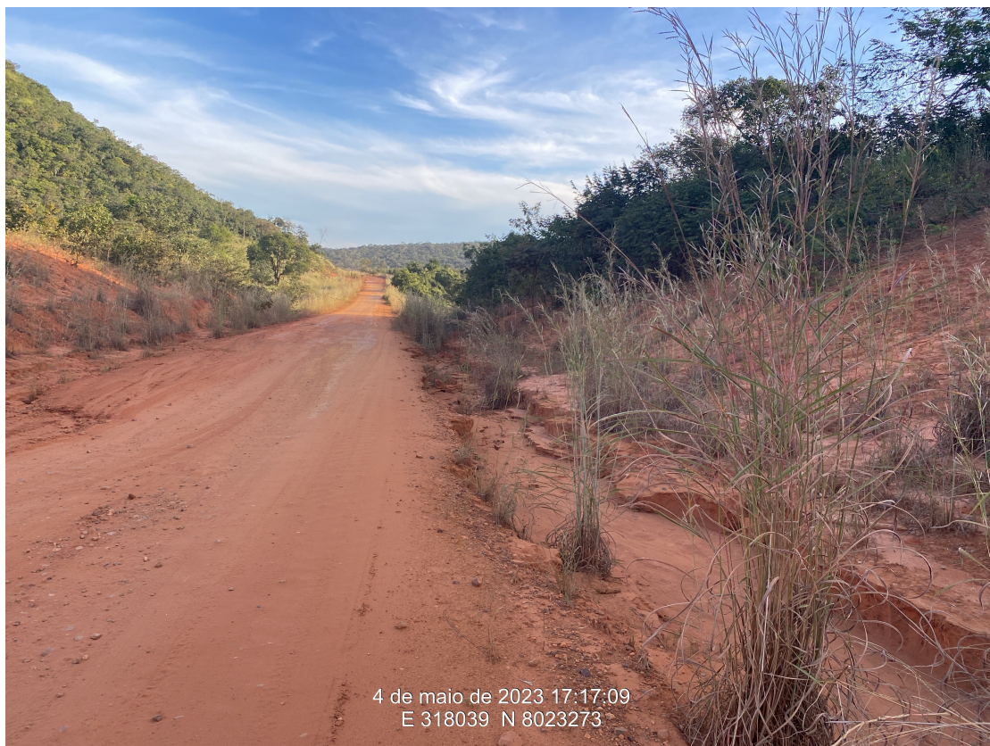
Km 27,90 – Processos erosivos nas laterais da pista
