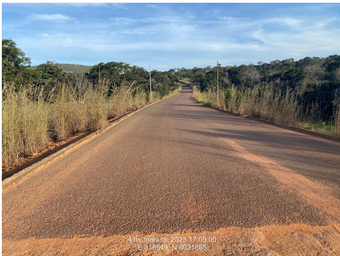
Km 26,30 – Aspecto do pavimento
