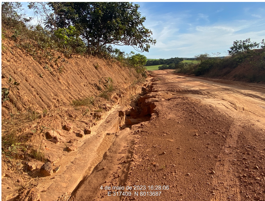
Km 17,00 – Erosão no pé de aterro
