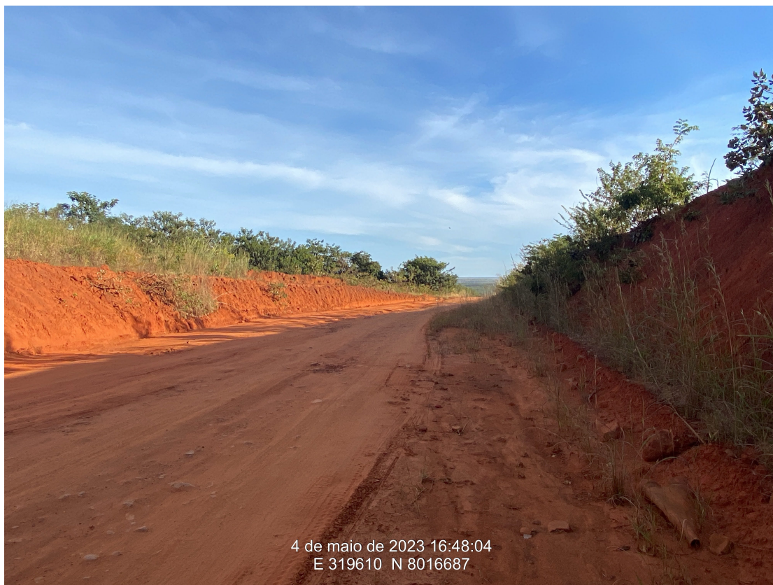
Km 20,00 – Talude com escorregamento de terra
