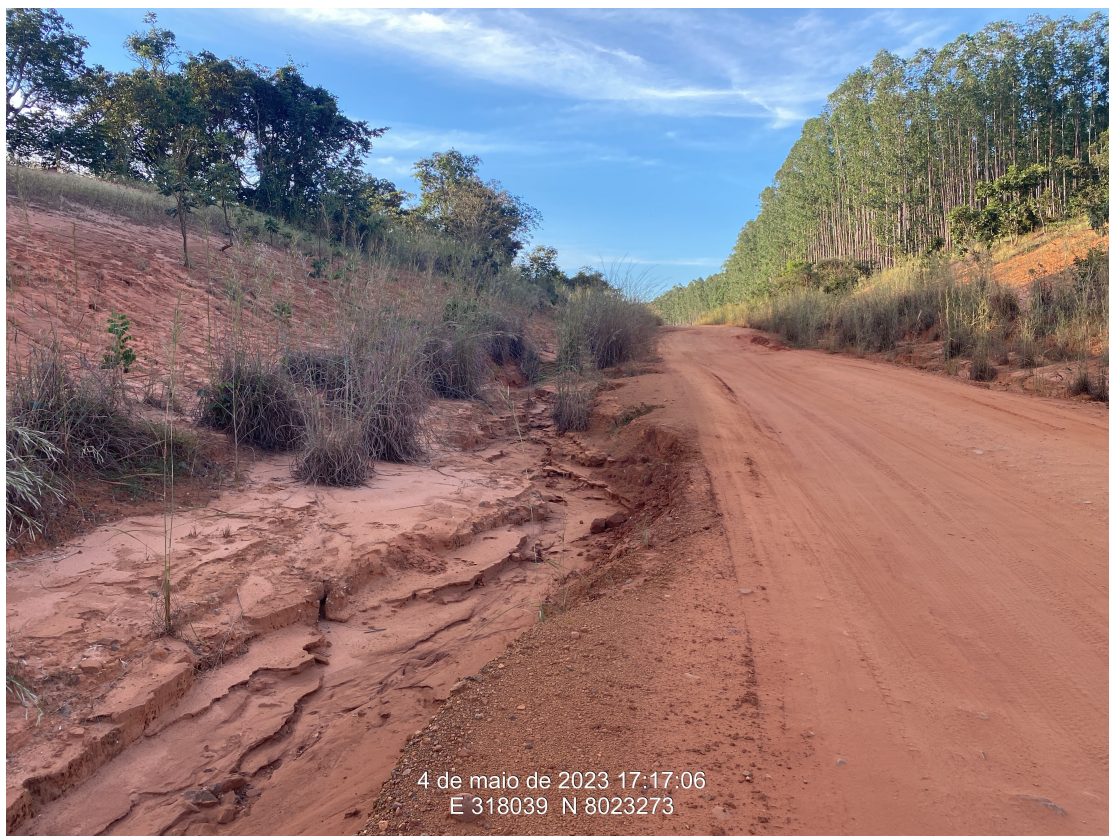
Km 27,90 – Processo erosivos no pé dos taludes
