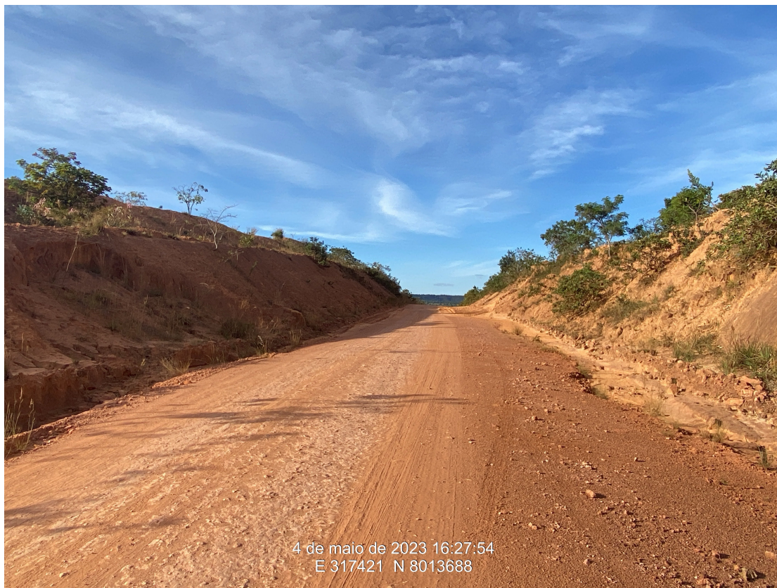
Km 17,00 – Taludes com escorregamento de terra
