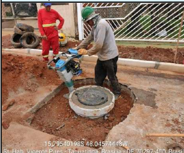
Tampão de Ferro Fundido Rua 10 - Chac. 320
