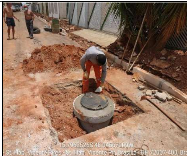
Tampão de Ferro Fundido Rua 10 - Chac. 320
