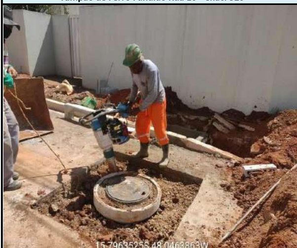
Tampão de Ferro Fundido Rua 10 - Chac. 319
