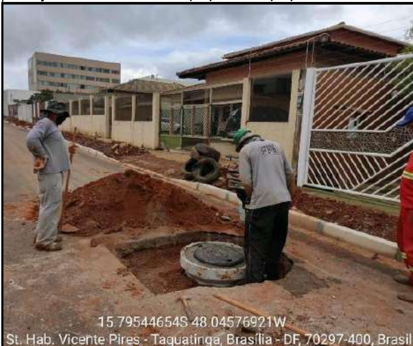
Tampão de Ferro Fundido Rua 10 - Chac. 320
