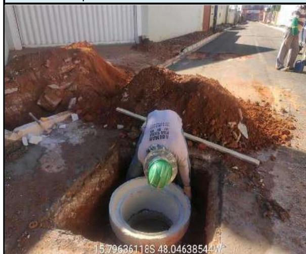
Tampão de Ferro Fundido Rua 10 - Chac. 319
