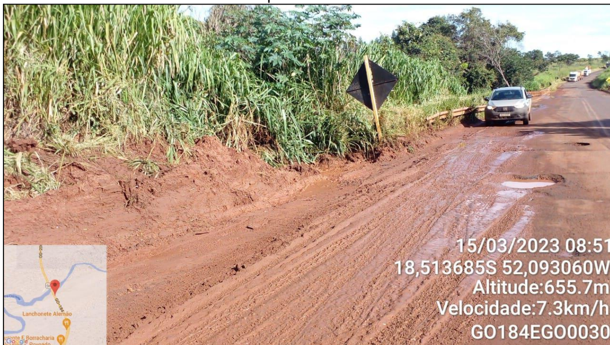
Figura 10 - Exemplo de via pavimentada com problemas de drenagem, limpeza e pavimento.
