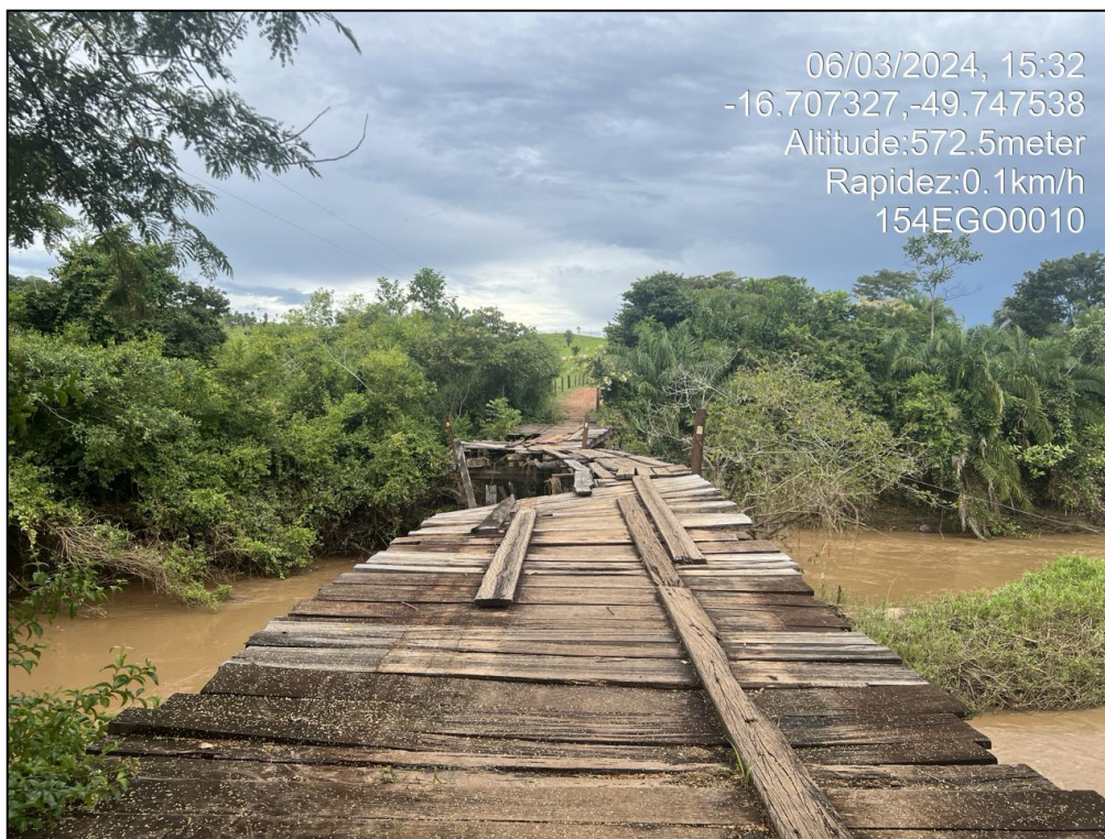
Figura 20 - Exemplo de ponte em madeira a ser recuperada.
