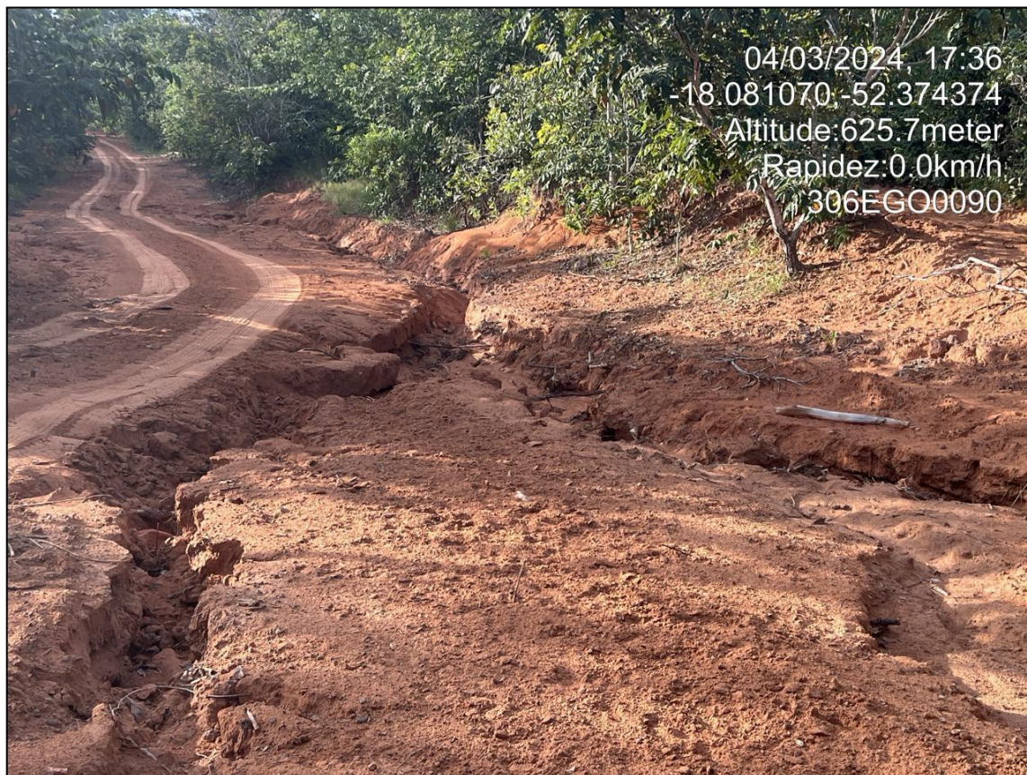
Figura 16 - Exemplo de via não pavimentada com graves problemas de processos erosivos causados pela inexistência de dispositivos de drenagem.
