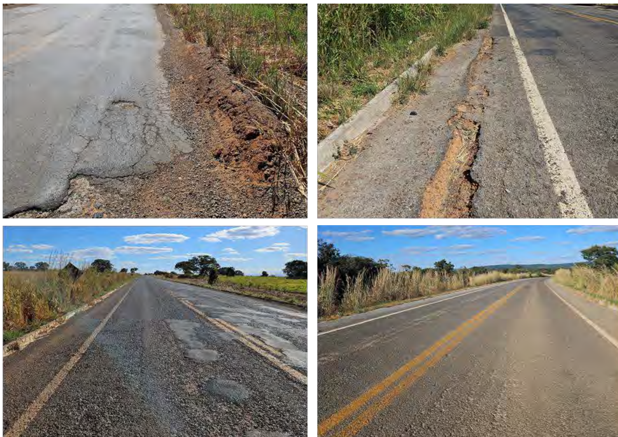
Figura 33 - Defeitos Superficiais no Pavimento GO-446 Fonte: Acervo do CONSÓRCIO.
