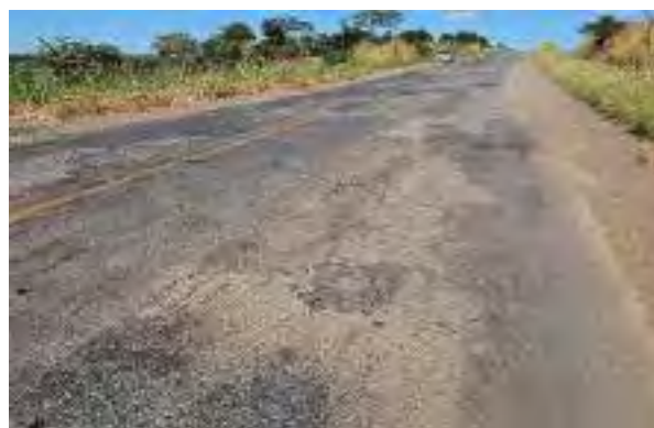
Figura 36 - Ausência de Sinalização adequada
