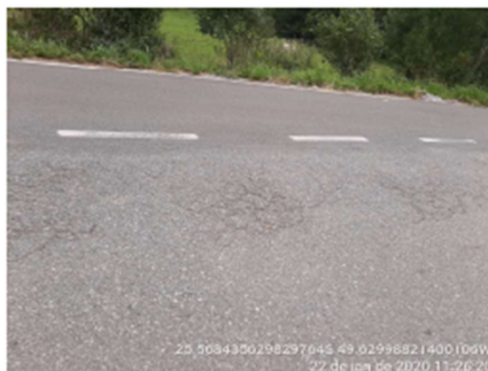
Figura 5 - Trincamento do tipo FC-2
