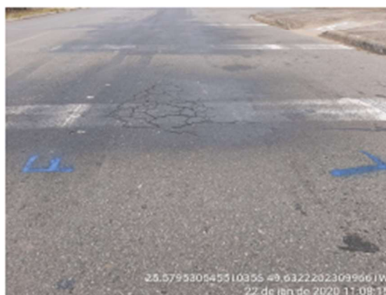
Figura 6 - Trincamento do tipo FC-2
