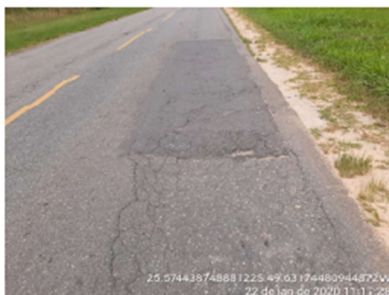
Figura 18 - Pista com remendo e trincamentos interligados
