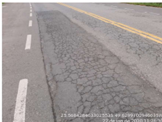
Figura 13 - Deformações localizadas e permanentes em trilhas de roda
