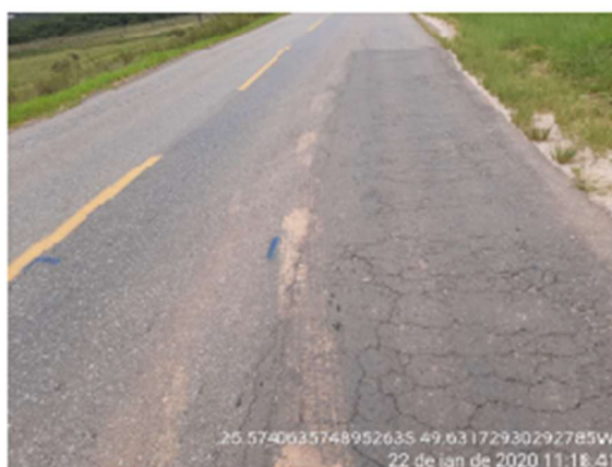
Figura 19 - Pista com remendo e trincamentos interligados
