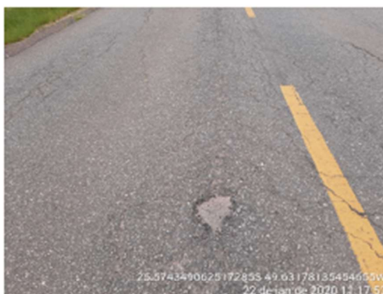
Figura 16 - Painela observada na pista
