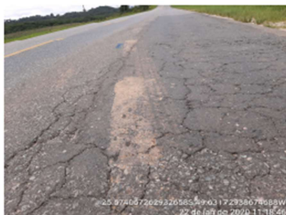
Figura 8 - Trincamento do tipo FC-2
