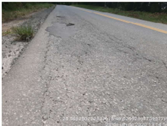
Figura 15 – Painela observada na pista
