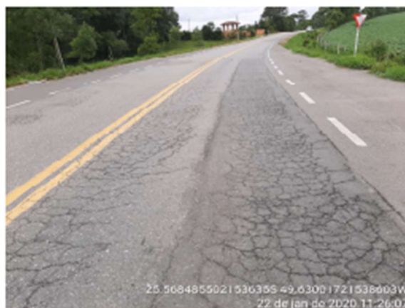
Figura 11 - Trincamento do tipo FC-2 e deformação permanente em trilhas de roda
