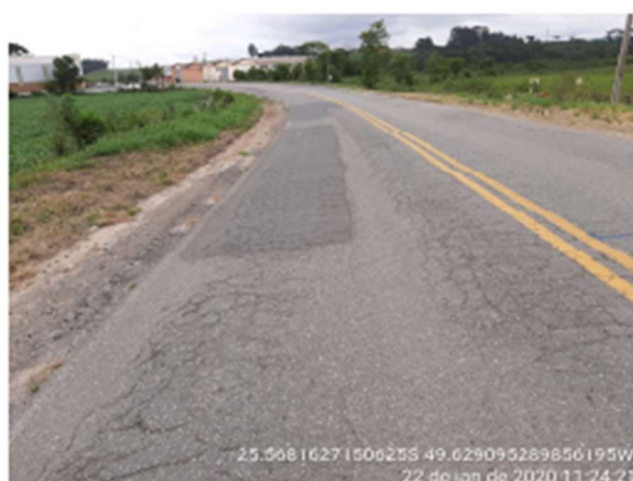
Figura 21 - Remendos e trincamentos interligados observados na pista
