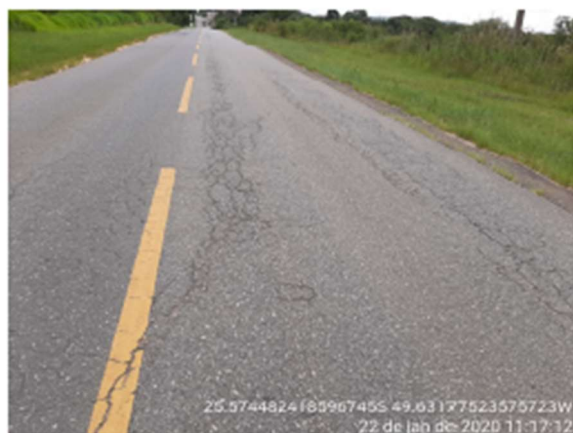
Figura 7 - Trincamento do tipo FC-2
