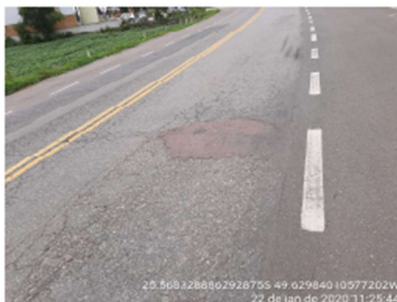
Figura 22 - Pista com remendo e trincamentos interligados
