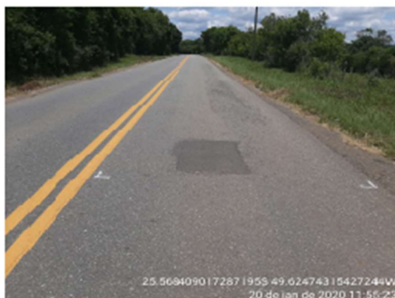
Figura 17 - Remendo observado na pista
