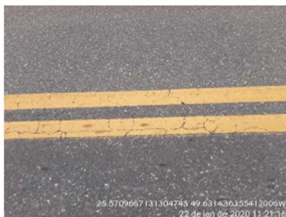
Figura 9 - Trincamento do tipo FC-2, no eixo
