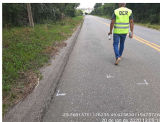
Figura 2 - Demarcação de defeitos in loco
