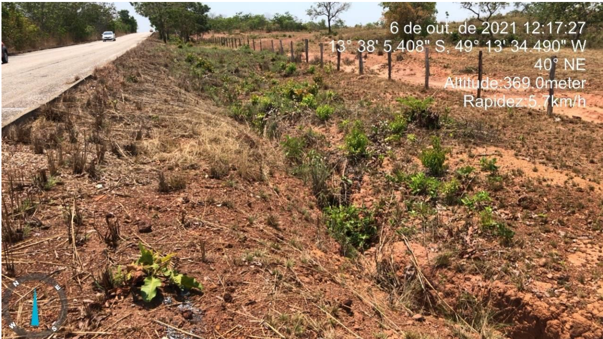
Figura 18: Ponto de saída de drenagem da pista causando a formação de processos erosivos.
