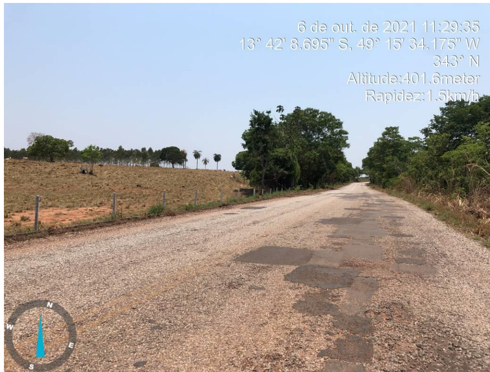
Figura 10: Trecho da pista degradado necessitando de restauração.
