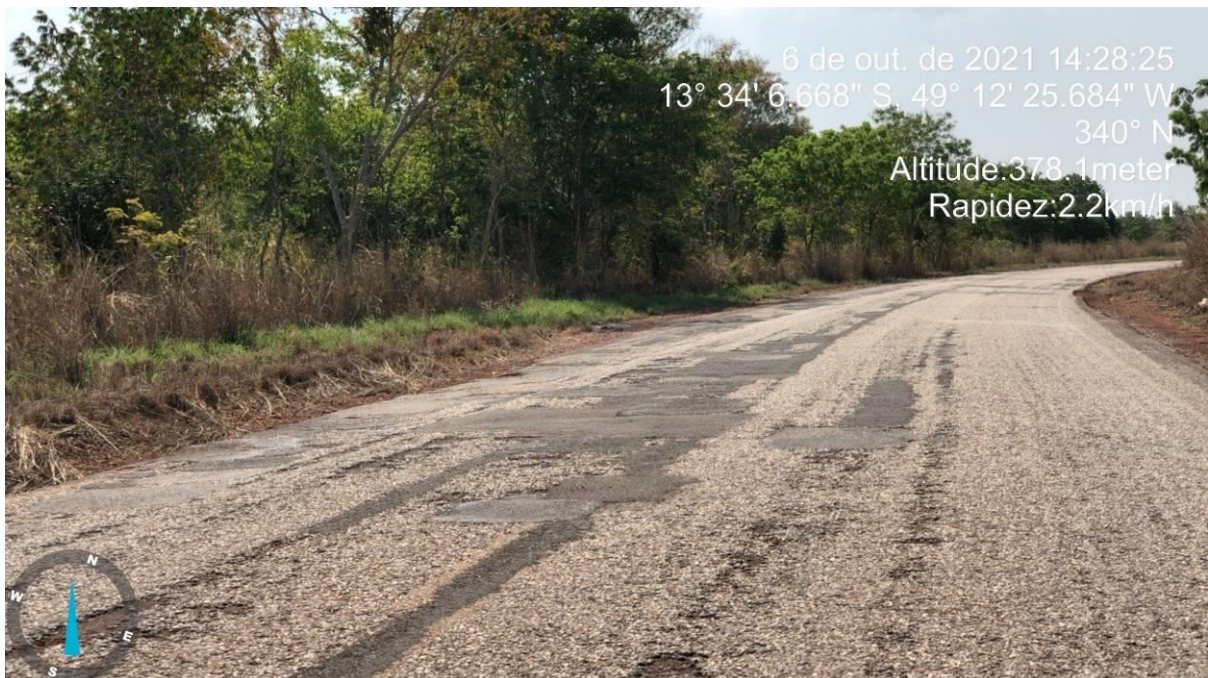
Figura 25: Ponto da pista em elevado grau de degradação.
