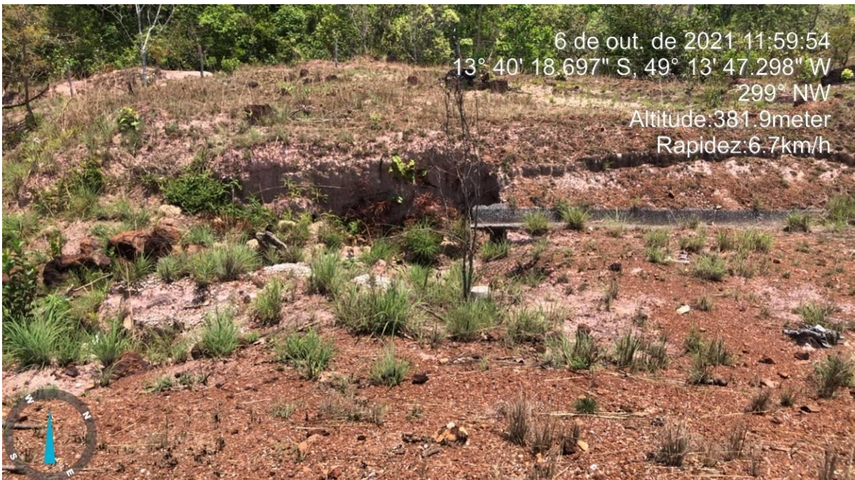
Figura 13: Ponto de saída da drenagem da pista com presença de processos erosivos.
