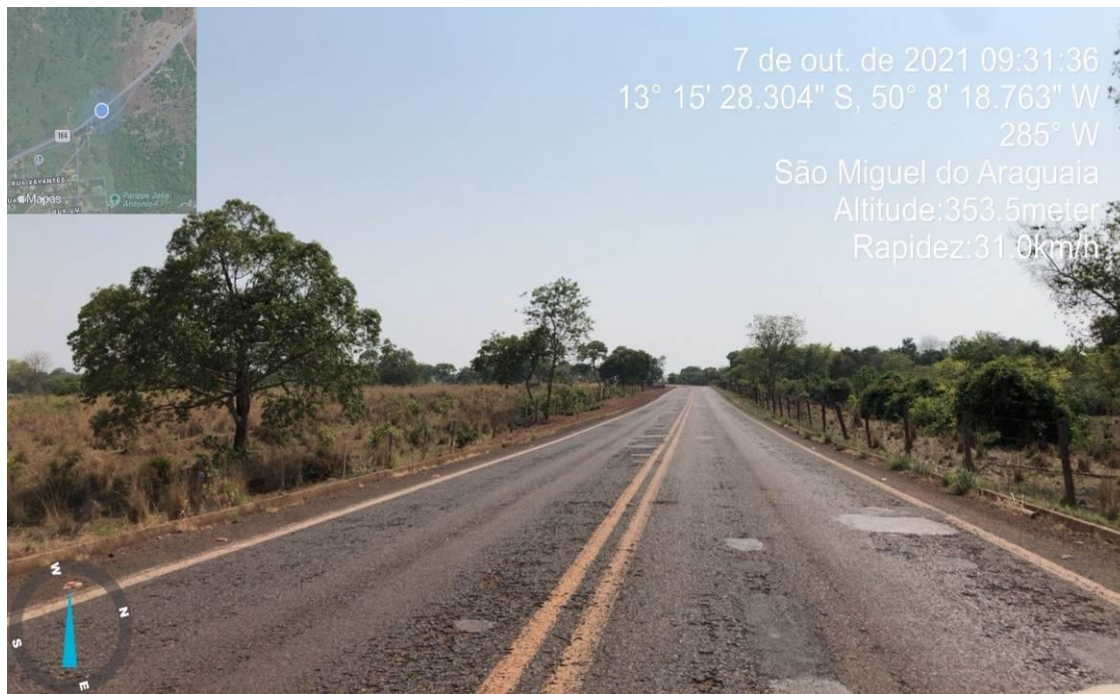
Figura 33: Trecho da pista com elevado grau de deterioração.
