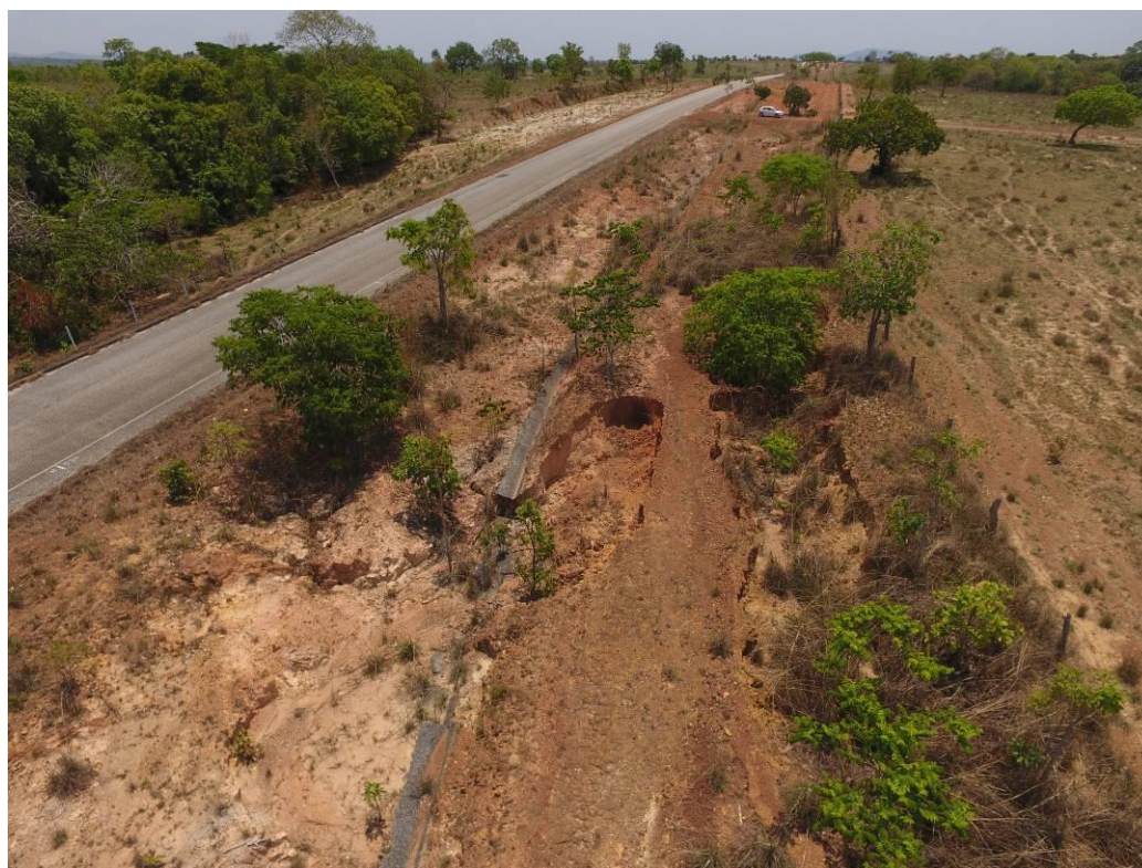
Figura 21: Processo erosivo significativo ao longo do sistema de drenagem da rodovia.
