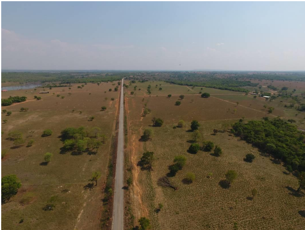
Figura 23: Demonstra a formação de processos erosivos em sulcos paralelamente à rodovia, ao longo de grande parte da faixa de domínio neste trecho.
