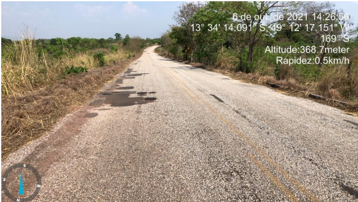
Figura 24: Ponto da pista em elevado grau de degradação.
