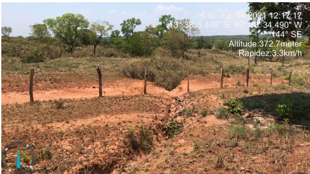
Figura 17: Ponto de saída de drenagem da pista causando a formação de processos erosivos.
