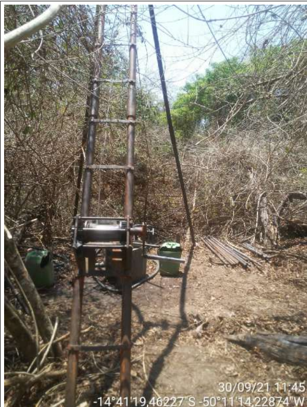
SM-01 – Equipamento instalado
