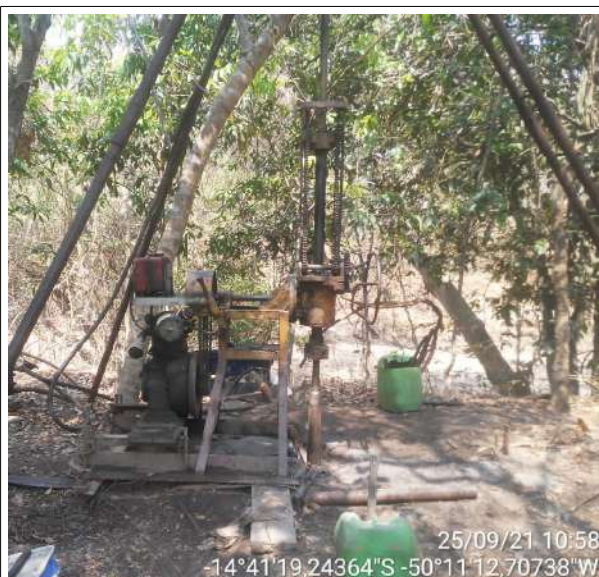
SM-02 – Equipamento instalado
