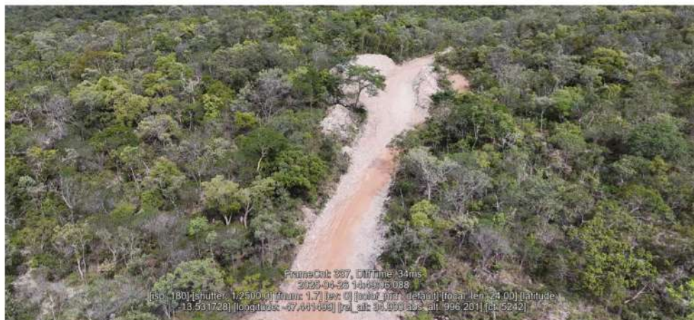
Figura 47 – Excedente de material de corte lançado nas margens da vicinal, no topo da rampa, que facilita o carreamento para o curso d'água.
