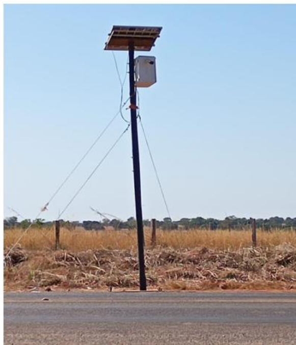
Figura 4 - Equipamento de Contagem Instalado
