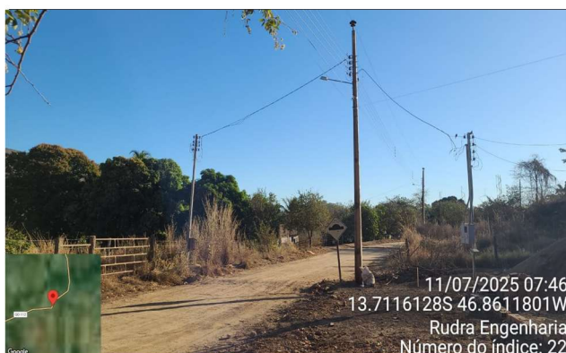
FOTO 22: km 4,35 - Povoado e Linha de baixa tensão
