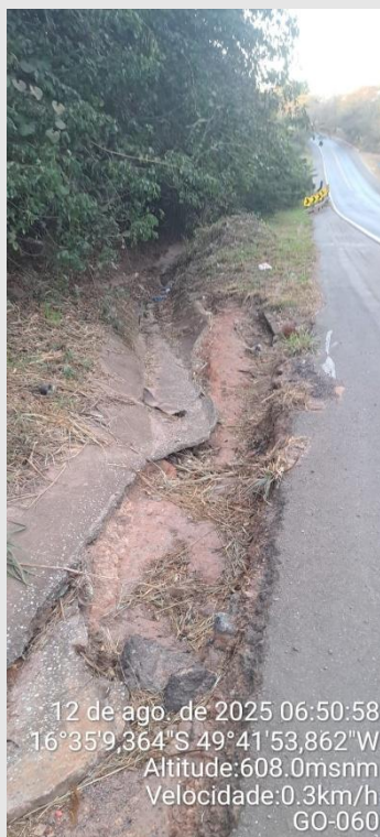
FOTO 07: Sistema de Drenagem Danificado
