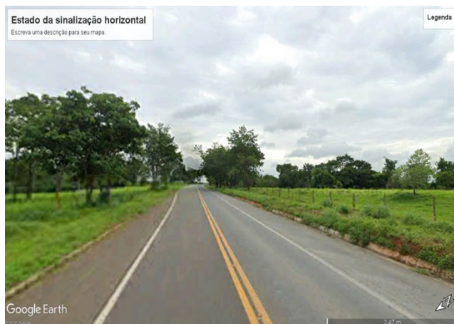
Foto: 13 – Estado da Sinalização horizontal
