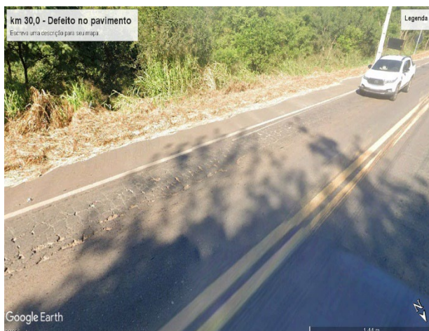
Foto 11 – Defeito no pavimento
