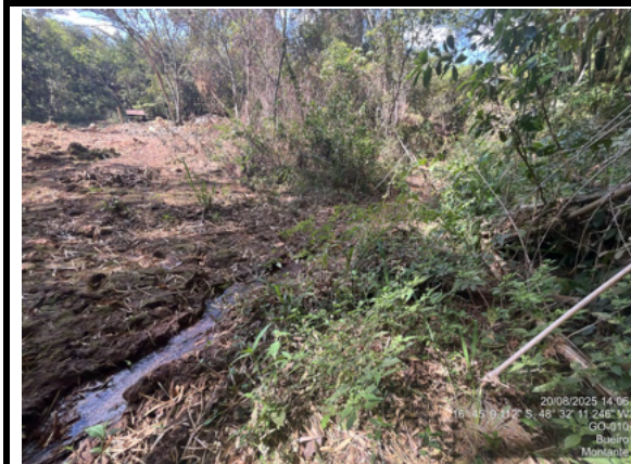
Figura 25. POSSÍVEL ÁREA DE ALAGAMENTO, BUEIRO COM OBSTRUÇÃO DE VEGETAÇÃO E BAMBUS.
