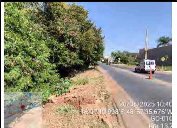
Figura 14. EM FRENTE AO SAMU – PROCESSO EROSIVO
