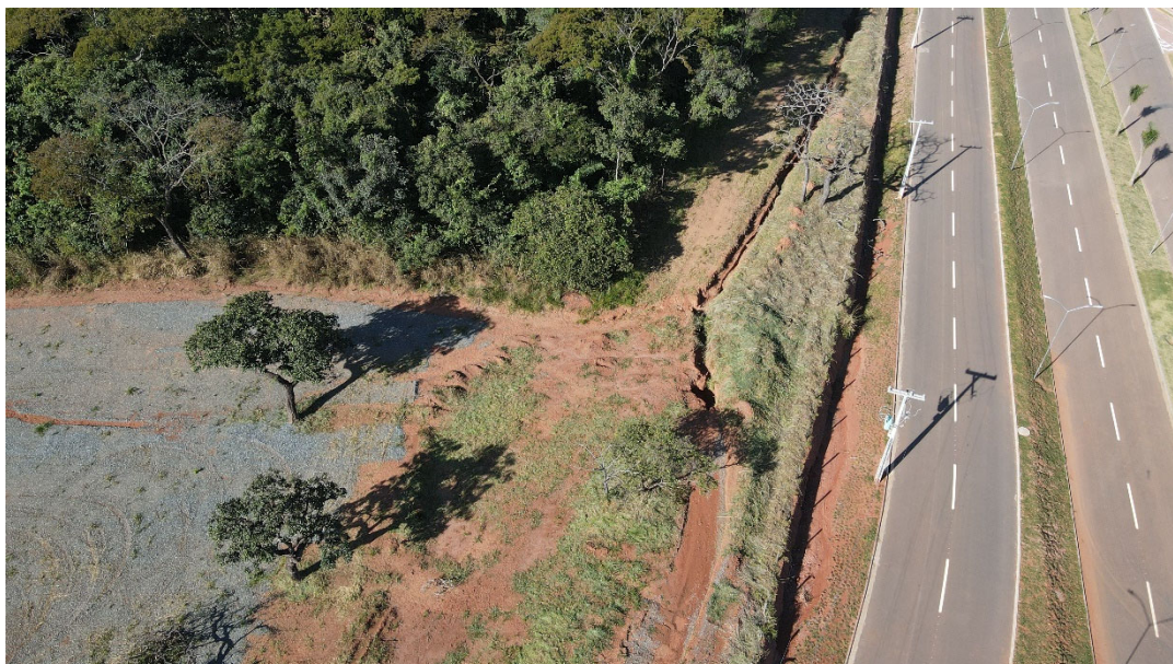
Imagem 10. Erosão na ÁREA 03-B
