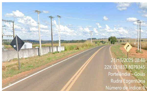
FOTO 6: km 0,41 - Subestação Portelândia - Equatorial (LE)
