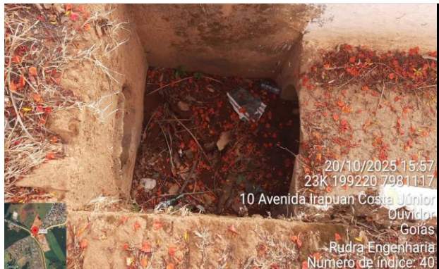
FOTO 20: km 12,90 - Bueiro entupido
