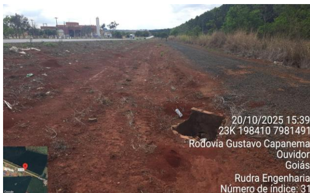
FOTO 17: km 12,20 - Caixa Coletora quebrada (enterrada)
