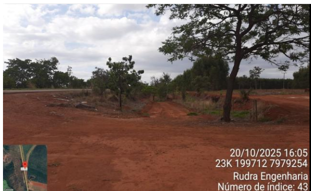
FOTO 22: km 14,70 - Caixa empréstimo sem recomposição (LE)
