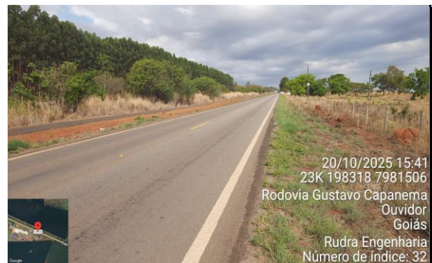
FOTO 16: km 12,10 - Poste (LE/LD) - Rede elétrica cruzando pista
