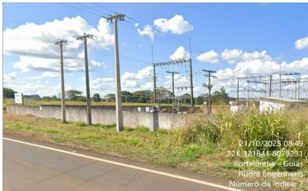
FOTO 7: km 0,47 - Rede elétrica cruzando pista
