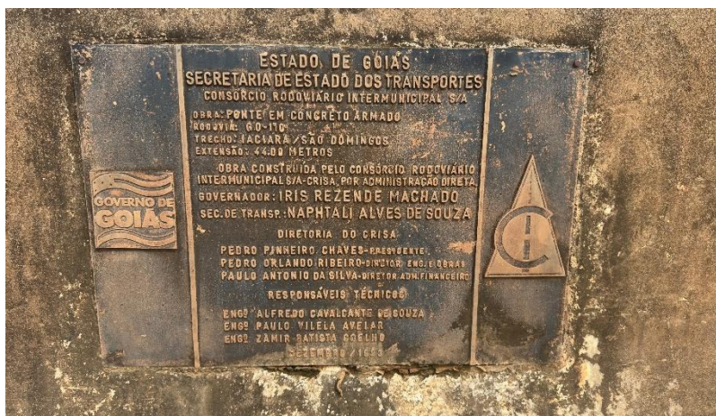
Figura 5 – Placa de informações da Ponte.
