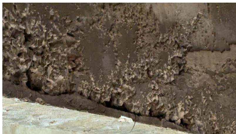
Figura 101 – Detalhes da armadura exposta e dos nichos de concretagem.
