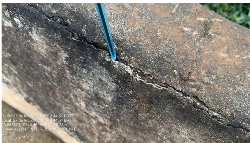
Figura 60 – Detalhe da trinca do New Jersey.
