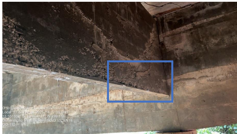
Figura 100 – Vista inferior da Transversina 01 apresentando nichos de concretagem.
