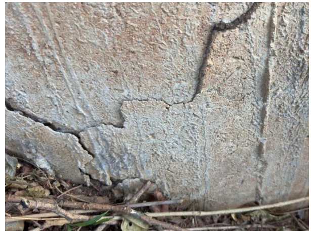
Figura 42 – Vista ampla da trinca no tubulão do Pilar 01.
