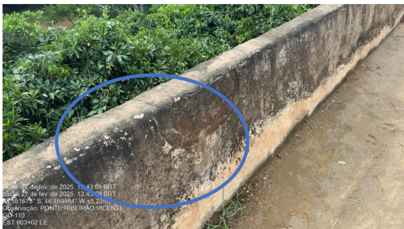
Figura 58 – Revestimento de concreto com deslocamento no New Jersey Estaca 903+02 LE.
