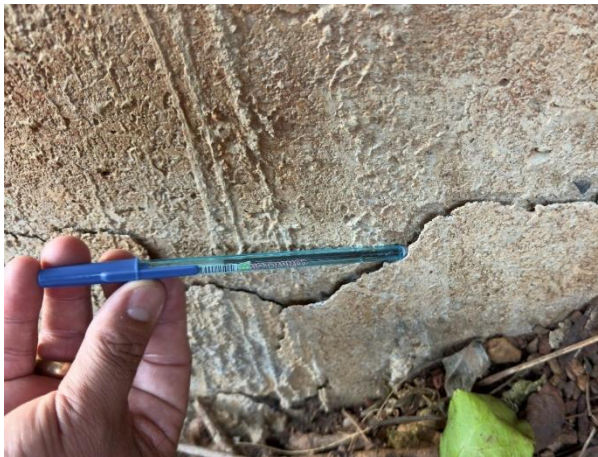
Figura 41 – Vista ampla da trinca no tubulão do Pilar 01.
