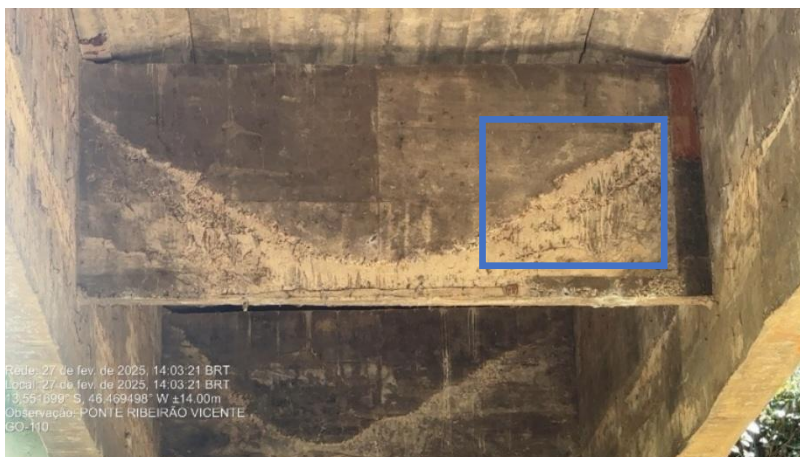
Figura 86 – Transversina 02 apresentando nichos de concretagem.
