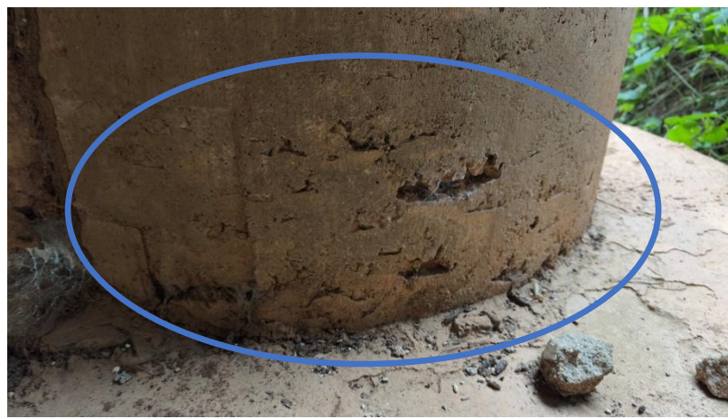
Figura 19 – Pilar 4 apresentando nichos de concretagem.
