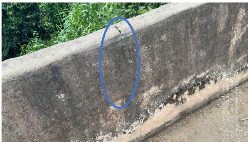
Figura 61 – Trincas no New Jersey Estaca 903+16 LE.
