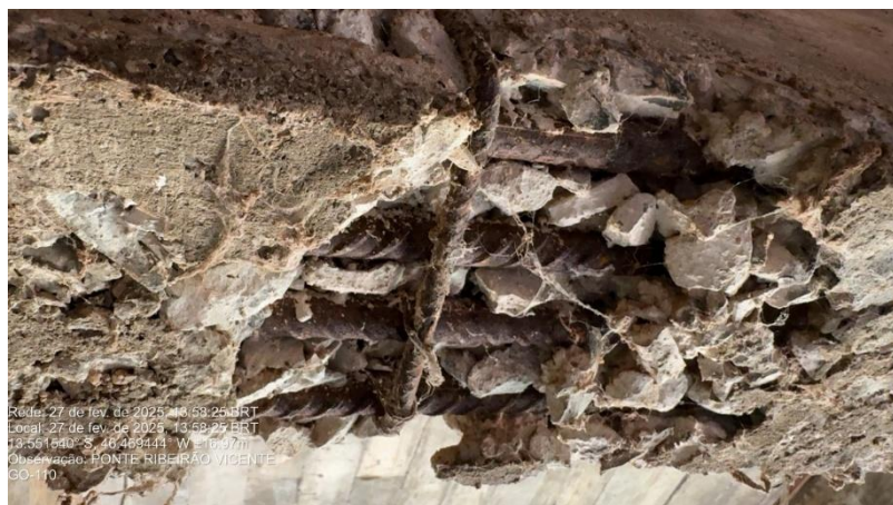
Figura 77 – Armadura com desagregação e exposição de armadura na transversina 06.
