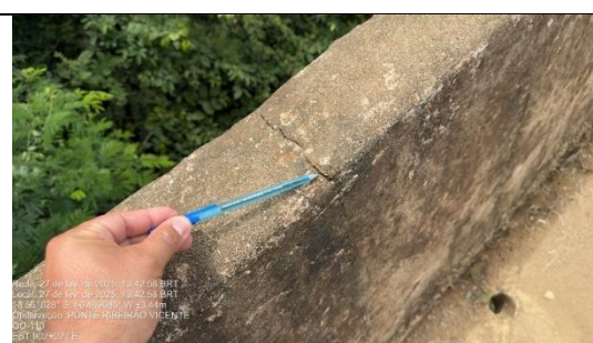
Figura 57 – Vista detalhada da trinca no New Jersey Estaca 902+02 LE.
