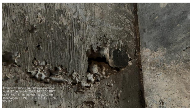
Figura 96 – Nichos de concretagem na Viga Longarina 01.
