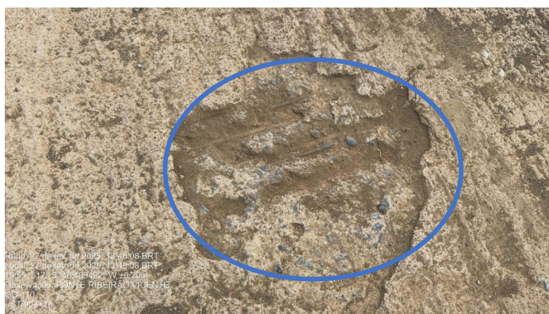
Figura 68 – Detalhes da armadura exposta.
