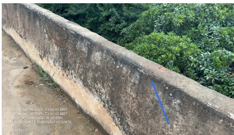
Figura 59 – Revestimento de concreto Estaca 903+03 LE com trincas.
