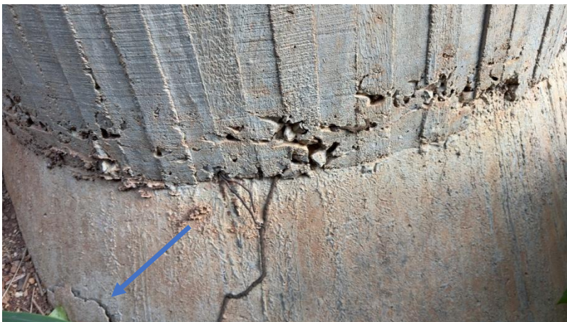
Figura 39 – Nichos de concretagem e trinca no tubulão do Pilar 1.
