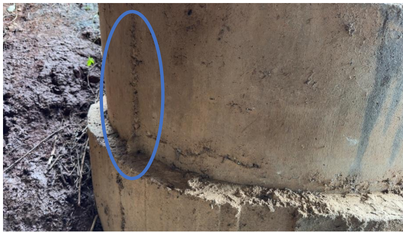
Figura 16 – Nichos de concretagem no Pilar 4.
