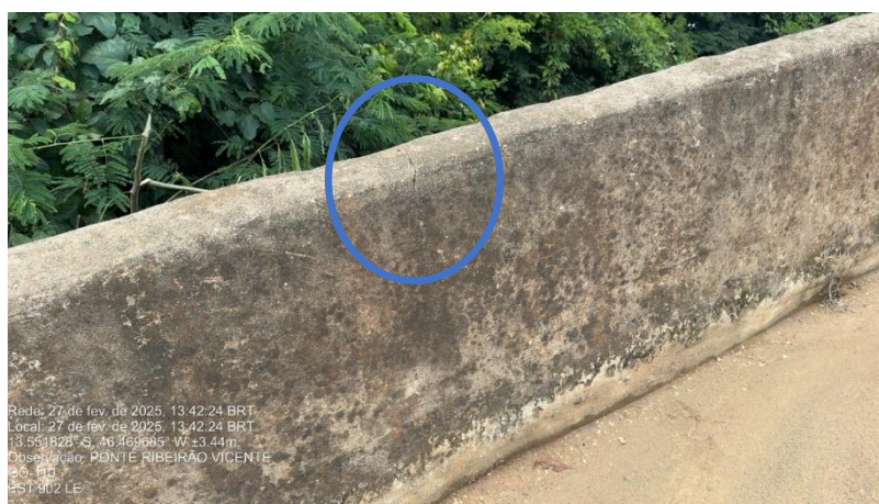
Figura 55 – New Jersey Estaca 902 LE apresentando pequenas trincas.
