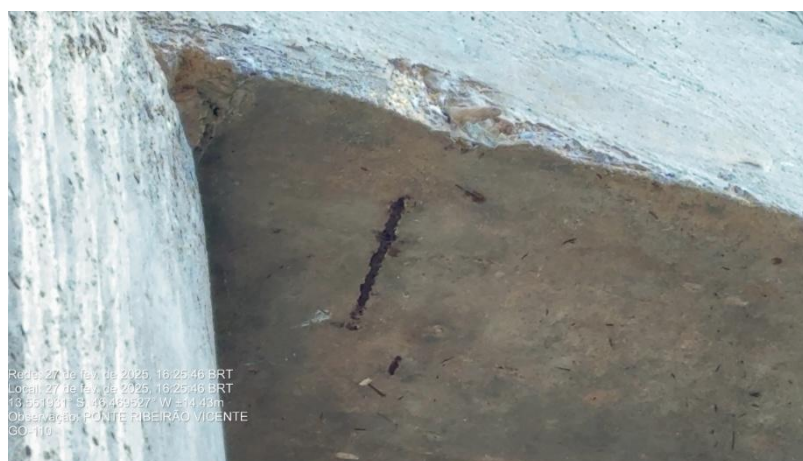
Figura 104 – Detalhes da armadura exposta com oxidação.
