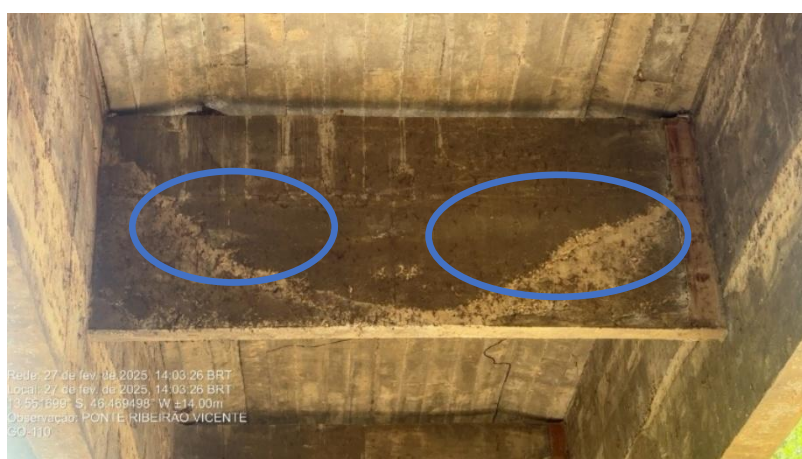
Figura 85 – Transversina 03 apresentando nichos de concretagem.
