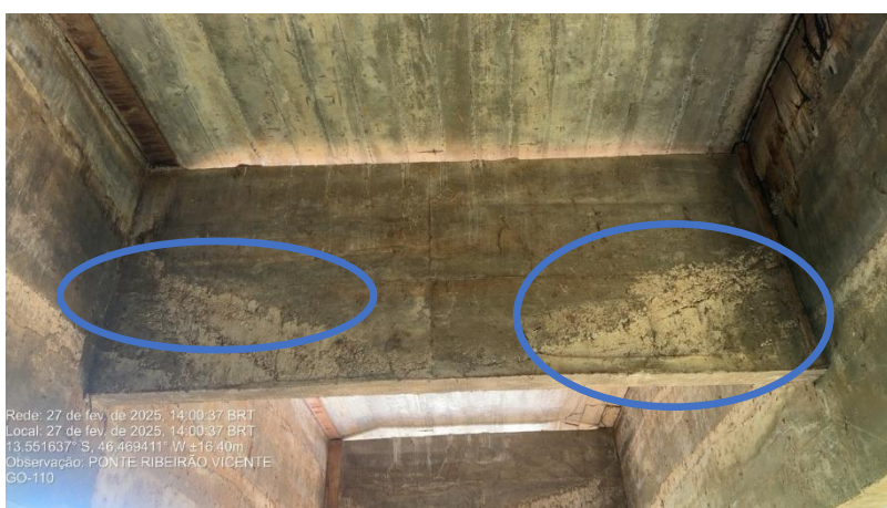
Figura 82 – Transversina 05 apresentando nichos de concretagem.
