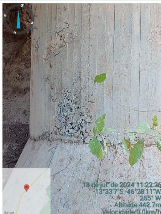
Figura 7 - Detalhe da superfície do concreto de um dos pilares da ponte (formação de nicho).
