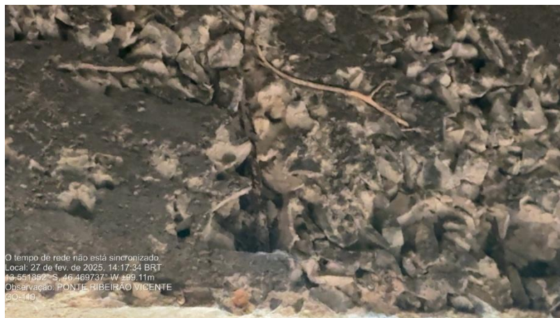
Figura 99 – Detalhes da armadura exposta e nichos de concretagem da Transversina 01.
