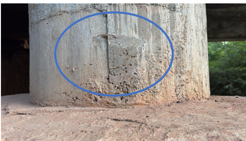
Figura 38 – Nichos de concretagem no Pilar 01.
