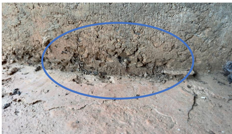
Figura 23 – Nichos de concretagem no encontro do Pilar 4 com o tubulão.
