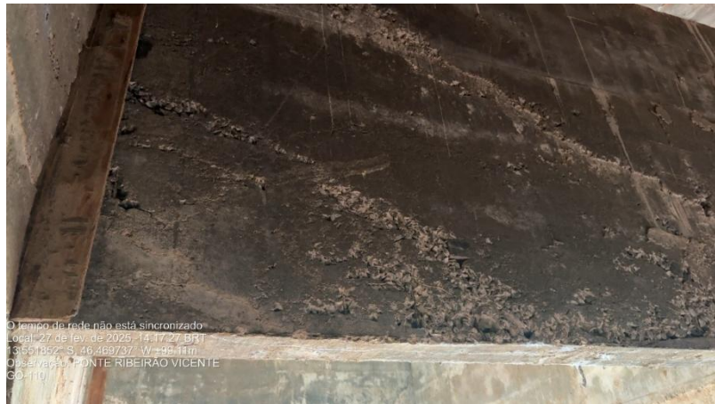
Figura 98 – Nichos de concretagem na Transversina 01 e armadura exposta.
