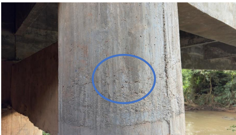
Figura 36 – Pilar 01 apresentando nichos de concretagem.
