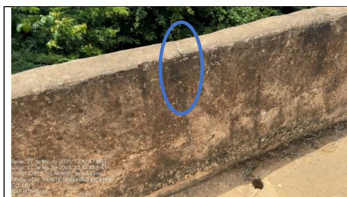
Figura 56 – New Jersey Est. 902+02 LE apresentando pequenas trincas.
