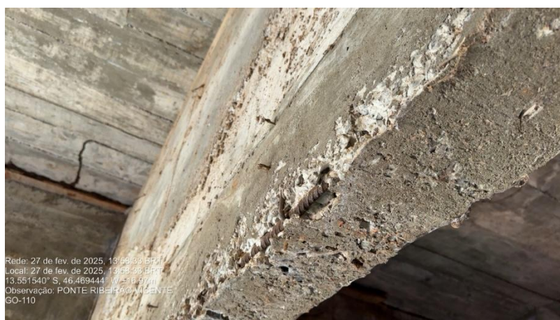
Figura 78 – Detalhes da armadura exposta na transversina 06.
