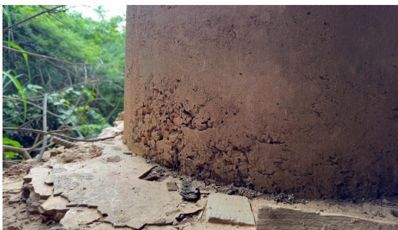
Figura 29 – Pilar 2 apresentando nichos de concretagem.
