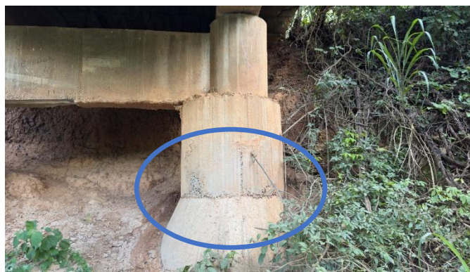
Figura 24 – Vista ampla do Pilar 2 apresentando nichos de concretagem.
