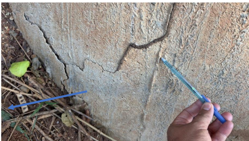
Figura 43 – Final da trinca no tubulão do Pilar 01.
