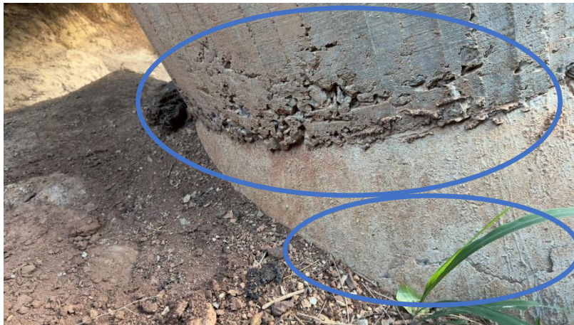
Figura 40 – Vista ampla dos nichos de concretagem do Pilar 01 e trinca no tubulão.
