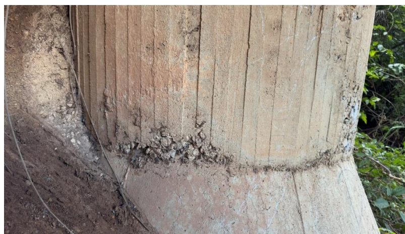
Figura 26 – Nichos de concretagem no Pilar 2.
