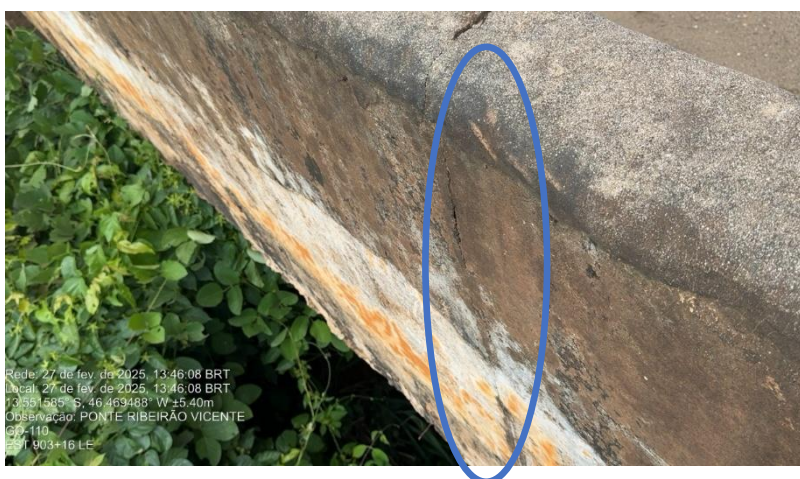
Figura 62 – Vista ampla da trinca na parte externa do New Jersey Estaca 903+16 LE.
