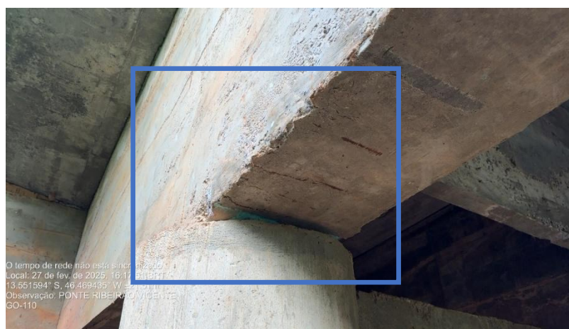
Figura 103 – Armadura exposta na viga longarina 01 próximo ao Pilar 01.
