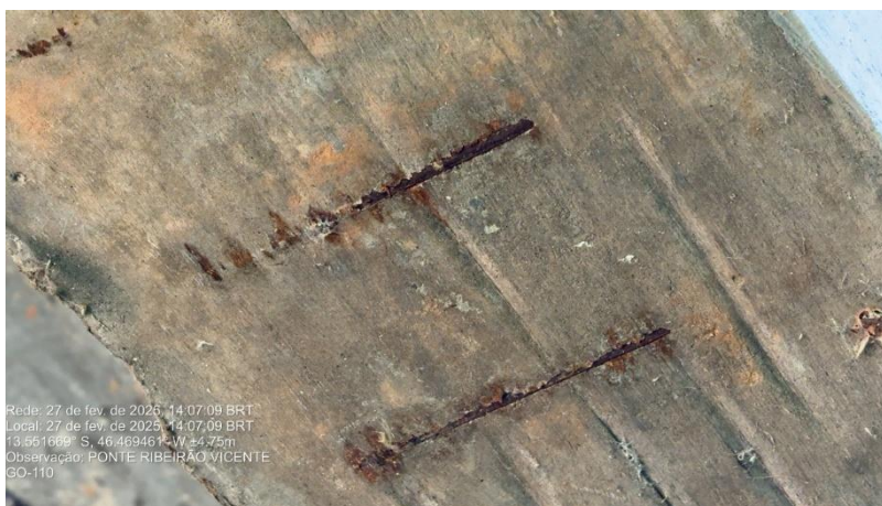
Figura 88 – Detalhes da armadura exposta com oxidação na Viga Longarina 01.
