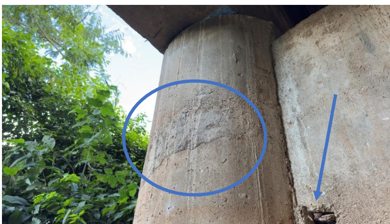
Figura 31 – Detalhes de falha na concretagem na região do Pilar 01.
