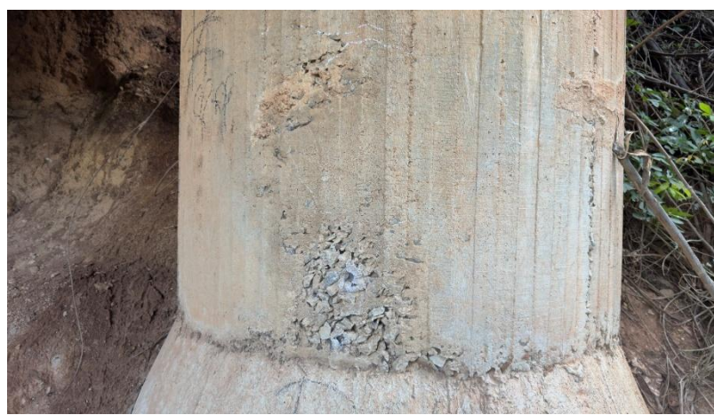
Figura 25 – Pilar 2 apresentando nichos de concretagem.
