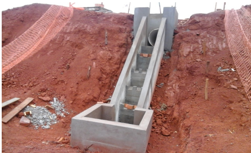
Figura 32. Dissipador de energia. Fonte: Monteiro Sales Engenharia.
