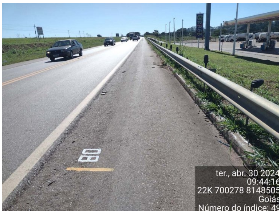
EST. 80 DEFENSA METÁLICA
