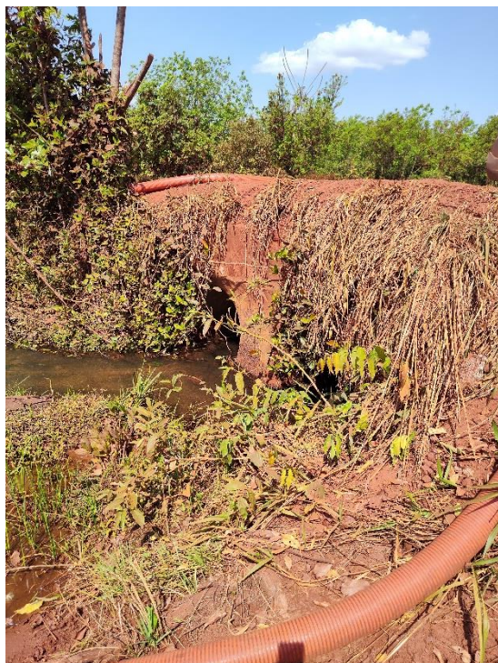
Foto 9 - km 27,8 - Bueiro tubular duplo.
