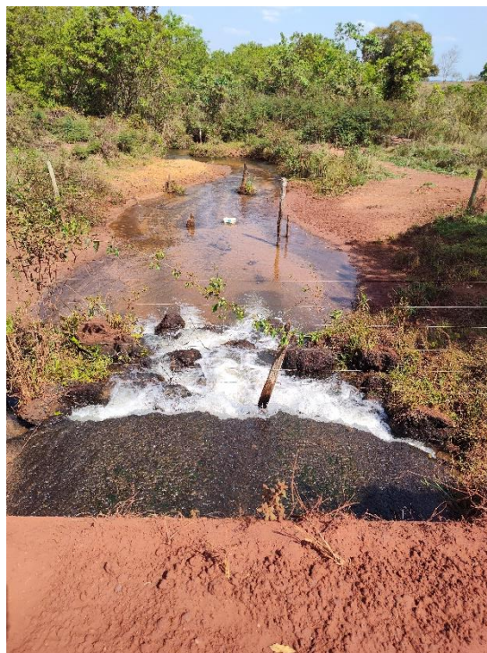
Foto 10 - km 27,8 - Bueiro tubular duplo.
