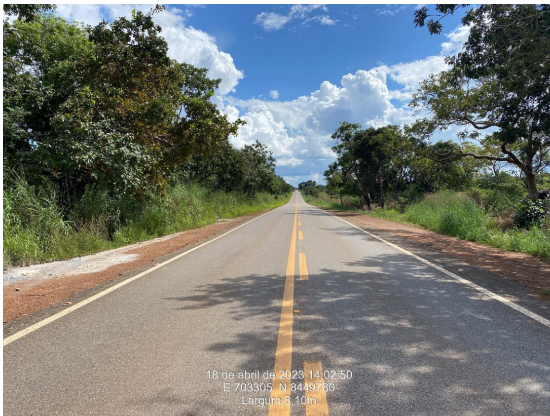
Km 3,6 – Situação do pavimento da pista e os acostamentos deteriorados.
