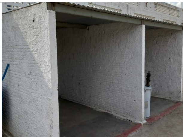
Imagem 7 - Área de Armazenamento de Equipamentos à Óleo (modelo a seguir).
