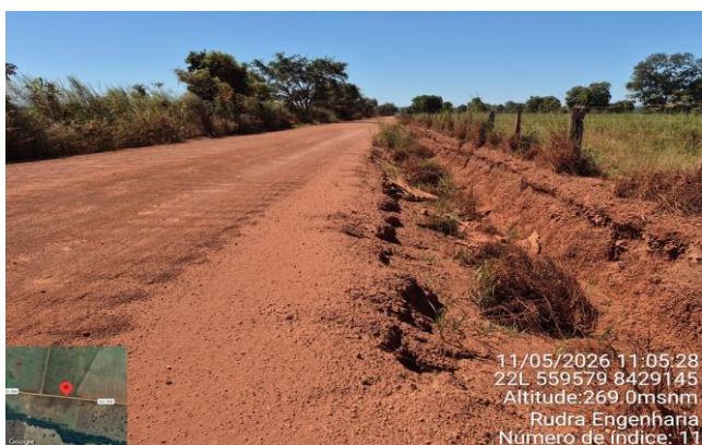
FOTO 11: Km 6,0 - Erosão no bordo da pista LE
